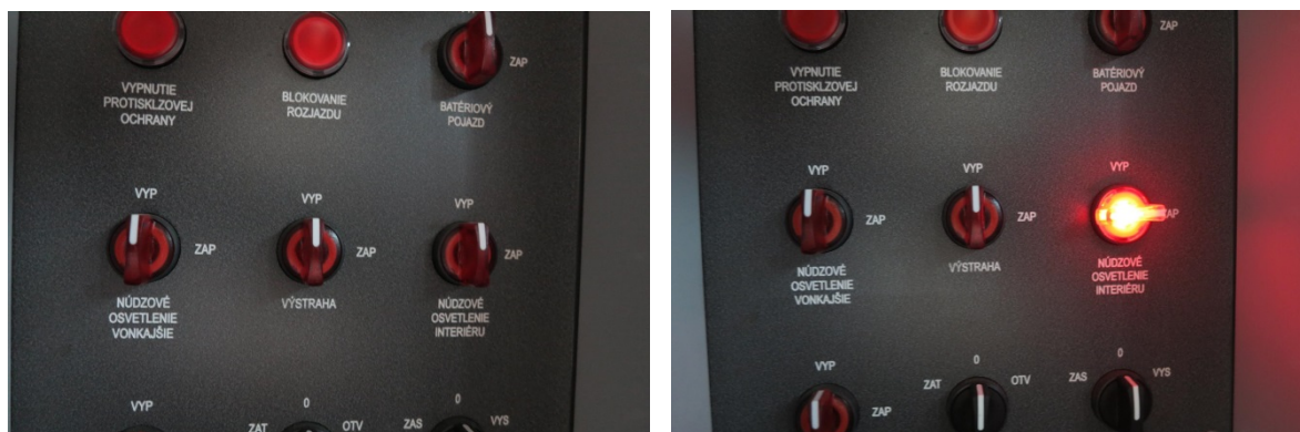
Obr.94 Núdzové osvetlenie interiéru vozidla
