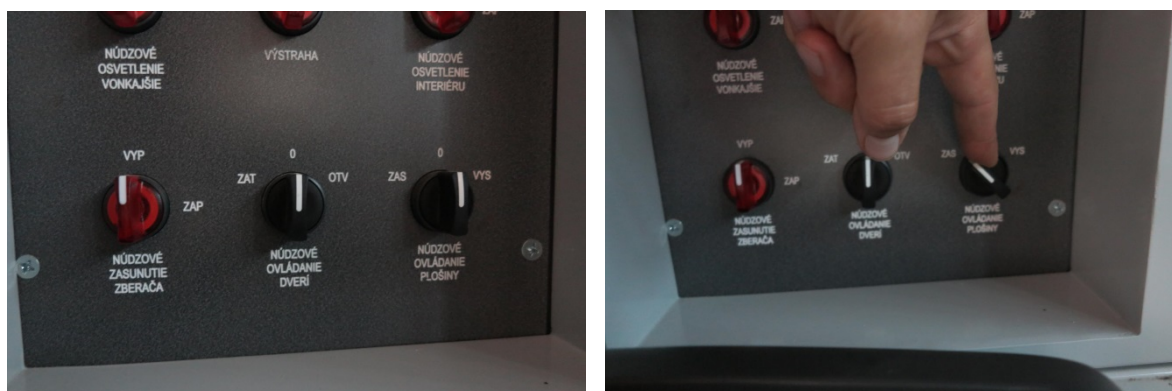
Obr. 97 Núdzové elektrické ovládanie plošiny
